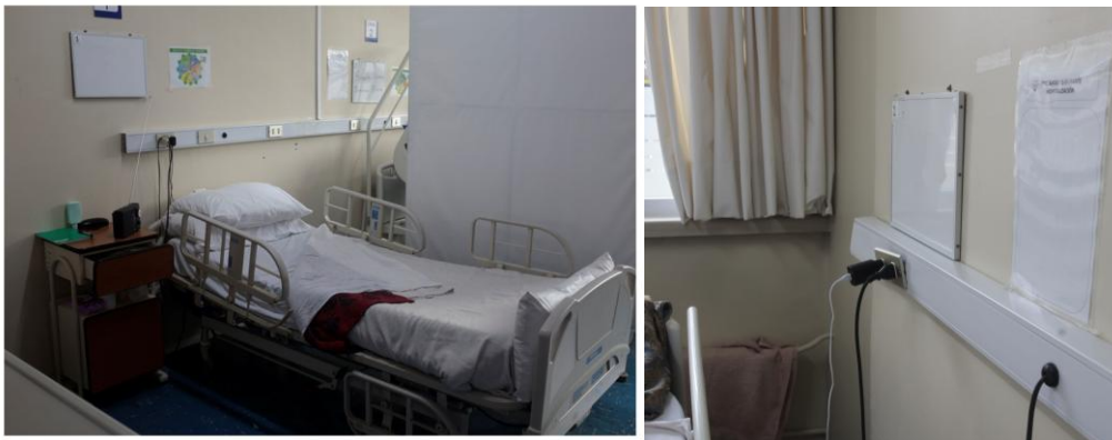
Fotografía N° 5 y 6: Cama y biombo y enchufe suelto
