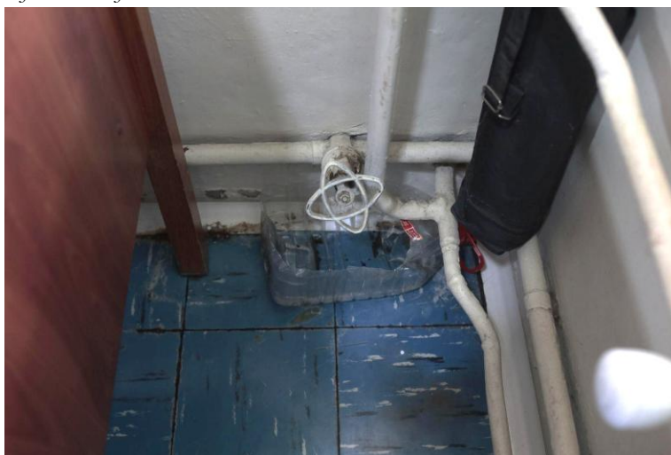
Fotografía N° 7: Calefactor con filtraciones
