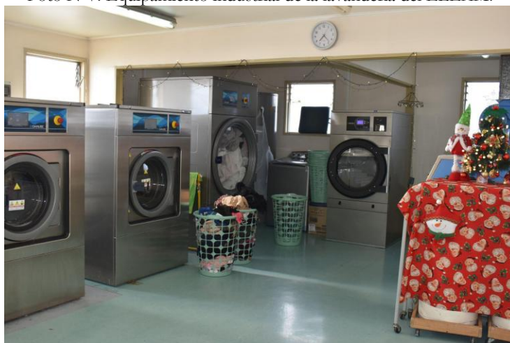
Foto N°7: Equipamiento industrial de la lavandería del ELEAM.
