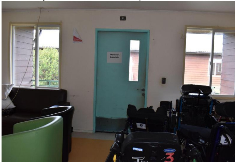
Fotos N°8 y 9: Salidas de evacuación bloqueadas en el establecimiento.
