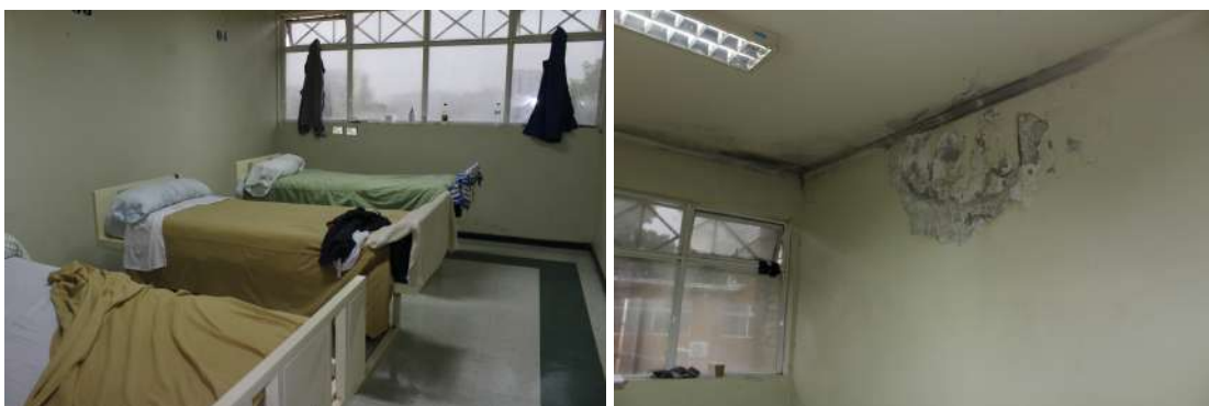
Fotografía N° 6 y N° 7: Dormitorio de la unidad y dormitorio con presencia de humedad
