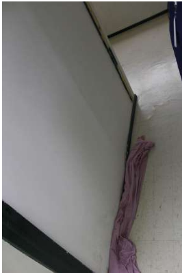
Fotografía N° 2: Dormitorio adyacente a baño del segundo piso con filtración de agua
