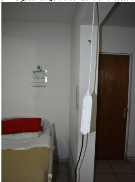
Foto N°3: Alargador colgando del techo en el establecimiento.
