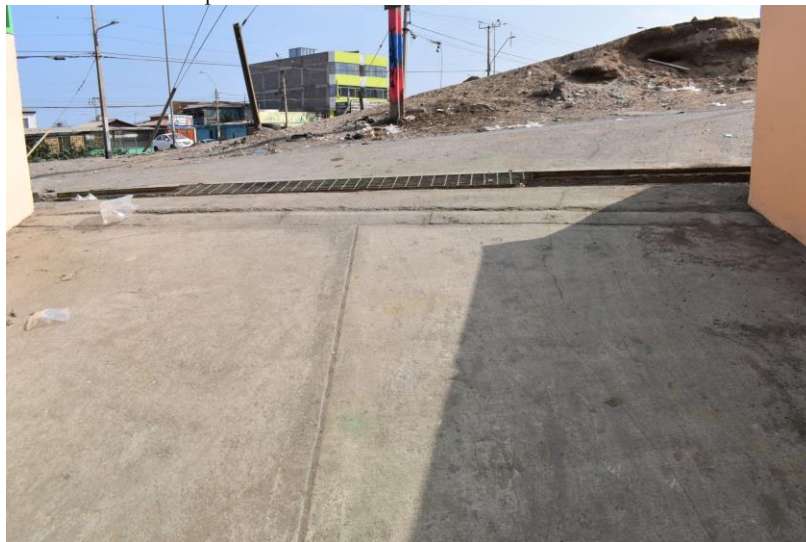
Foto N°12: Rampa o salida inclinada de la vía de evacuación de la zona 3.
