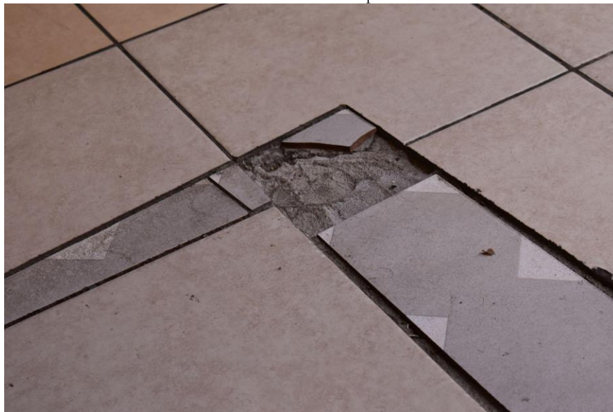
Foto N°2: Falta de cerámica en un pasillo del ELEAM.
