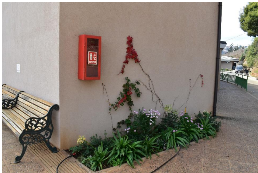
Foto N°9: Gaveta de incendios ubicada en el exterior de la entrada del ELEAM, vacía.
