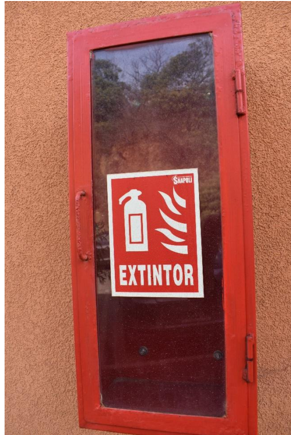
Foto N°8: Gaveta de incendios ubicada en la zona de seguridad (estacionamiento), vacía.
