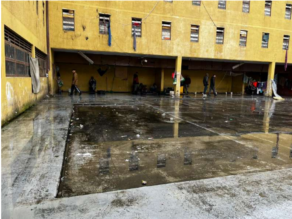
Patio del módulo 43 de personas condenadas. Los espacios techados son reducidos e igualmente se encuentran húmedos.
