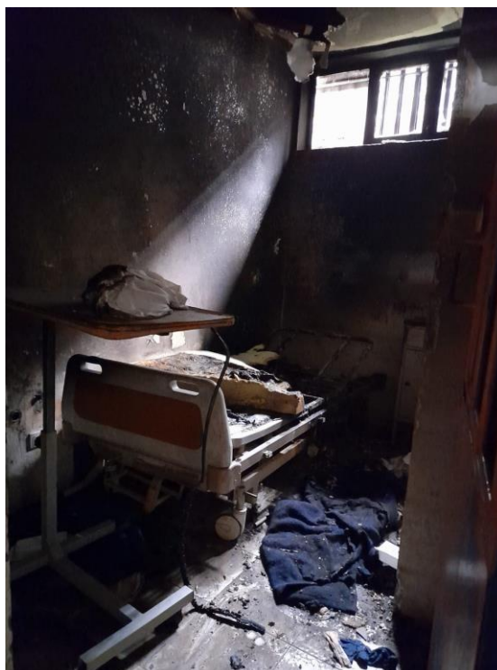
Habitación de aislamiento antes y después del incendio.
