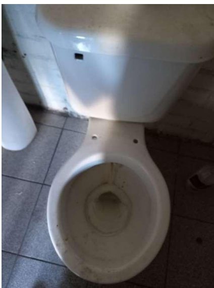
Fotografía N° 8 (Inodoro en sanitario del área de celdas)
